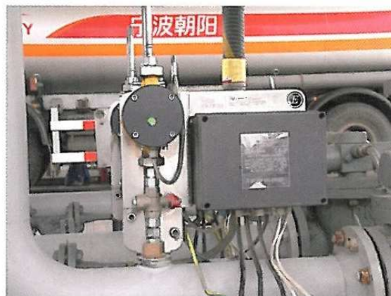
Precizní aditivační jednotka „EVA6“ instalovaná na skladu firmy Sinopec v čínském městě Ningbo, High precision additive dosing unit „EVA6“ installed on fuel storage of company Sinopec in city Ningbo (China)
