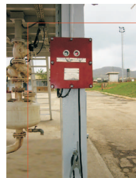
Instalación de EGT 3.1 en el NATO Snake Depot, depósito de combustible, en Pristina, Kosovo
